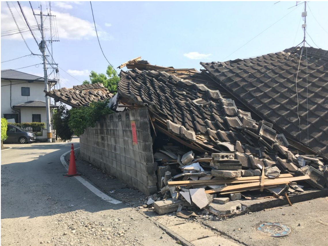
写真 1 倒壊した住宅を支えるブロック塀
